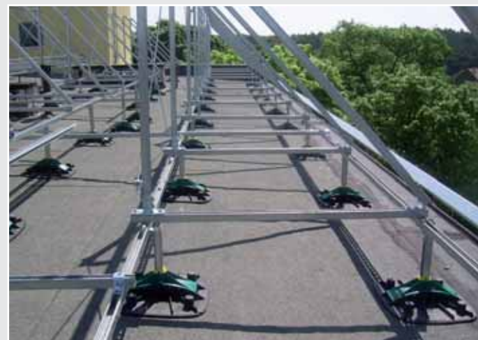
Солнечные коллектора на кровле - Госпиталь - Барлинек (Польша)
