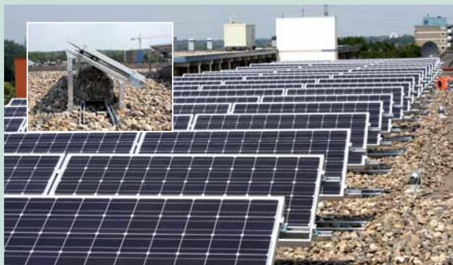
Солнечные коллектора - Жилое здание - Энсхеде (Нидерланды)
