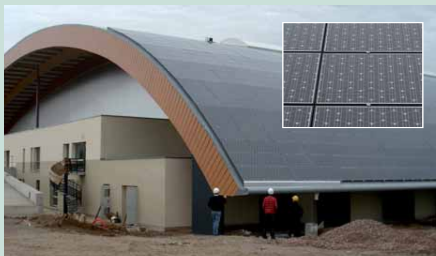
Солнечные коллектора на кровле - Спортивный центр - Аржес (Франция)
